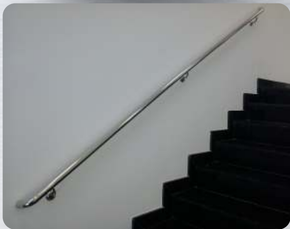
Corrimão Aço Inox fixado a parede
