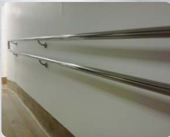
Corrimão Aço Inox Duplo fixado a parede
